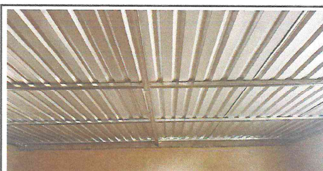
Foto 4: Estructura metálica y lámina troquelada en la cocina de la escuela
